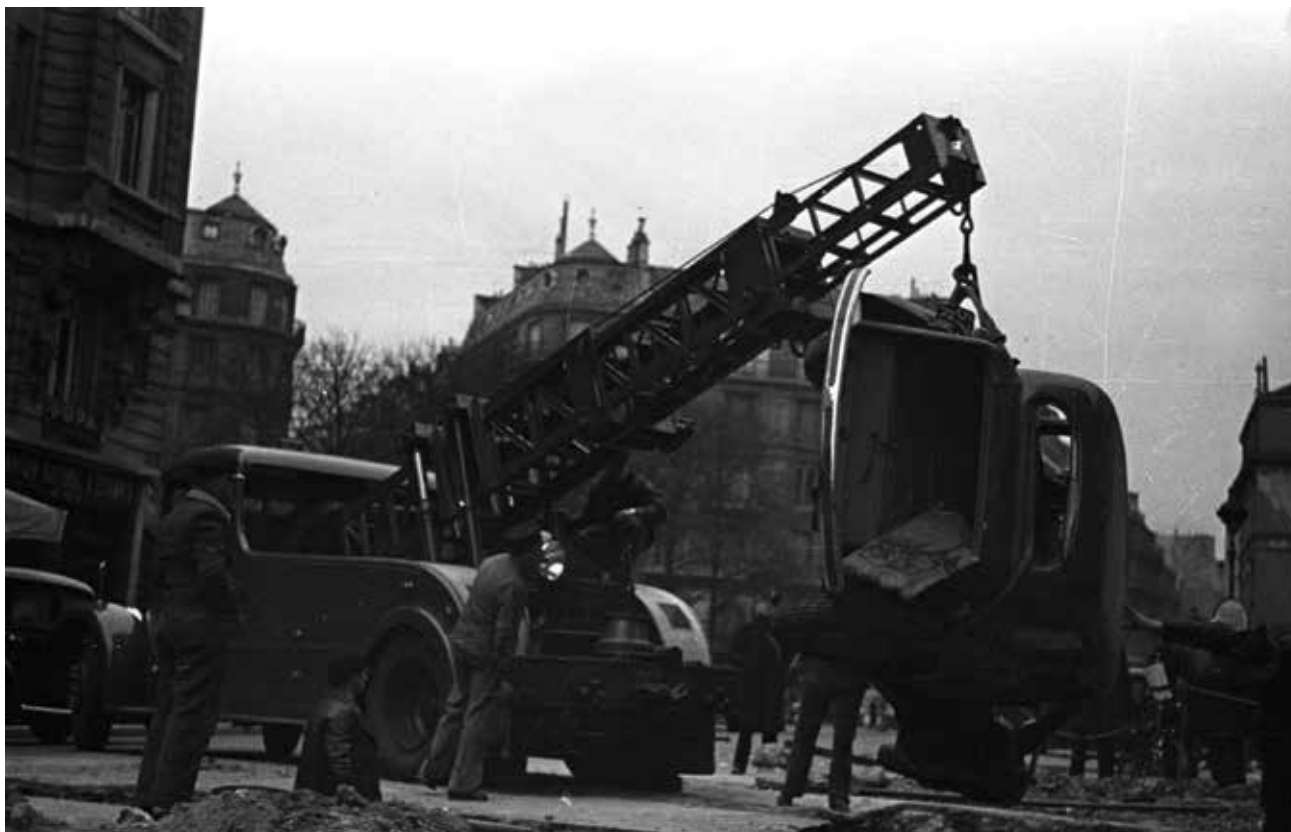
Relevage par camion-grue d'une voiture tombée dans une tranchée. Angle de la rue de La Boétie et de la rue du Faubourg-St-Honoré, 1 er mars 1940. © BSPP
